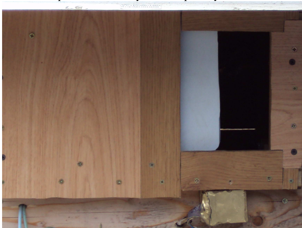
Фото реально используемой дверцы с установленным под ней датчиком:
